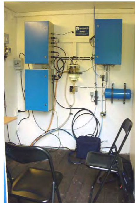
Aus einer integrierten Messtation in Polen
