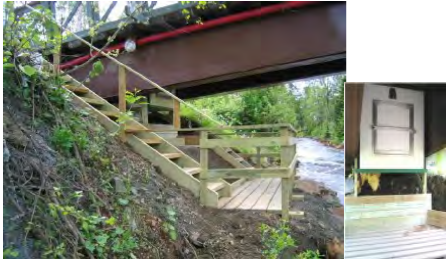
Eine Messstation unter einer Brücke
